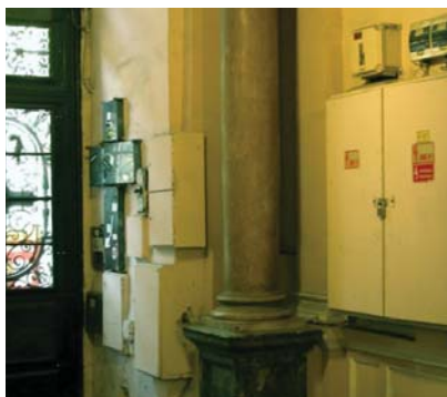
Elosztószekrények, falon kívül vezetett vezetékek
