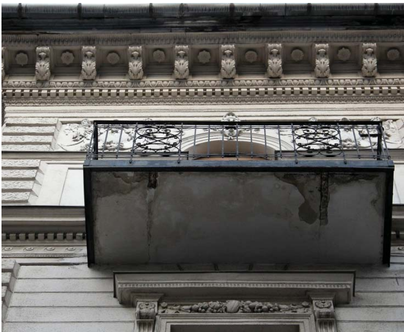
Acélgerendákra ültetett erkély. A vízcseppentő hiányában leázott az erkély alatti vakolat.
